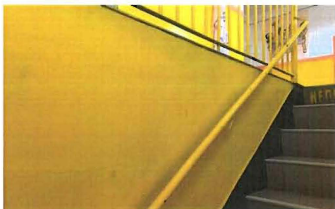
Slika 1. Pukotina u zidu kod stepeništa.
